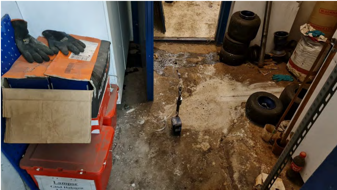
Figur 5.5 Provpunkt 23SM03, mätpunkt för porluft. Punkt placerad i värmecentral.
