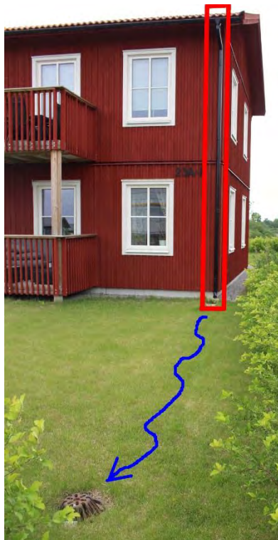
Figur 13. Avledning av takvatten via utvändigt stuprör (inringat i rött) till grön yta. Diffus spridning underlättas via plattsättning under stupröret (ej synligt på fotot). Dagvattnet har därefter en längre sträcka till avledning via dagvattenbrunn, demonstrerat med blå pil.
